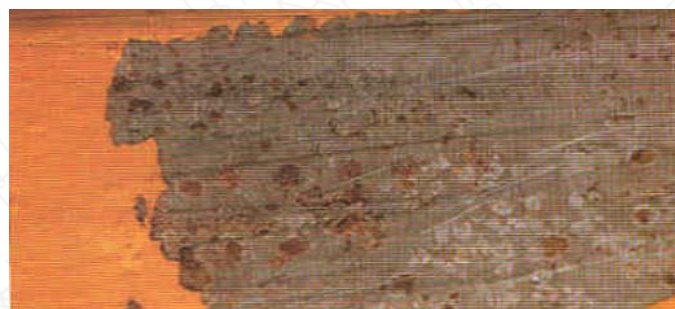
Slika 3: Točkasto prohrđavanje radi ne odstranjene okujine
