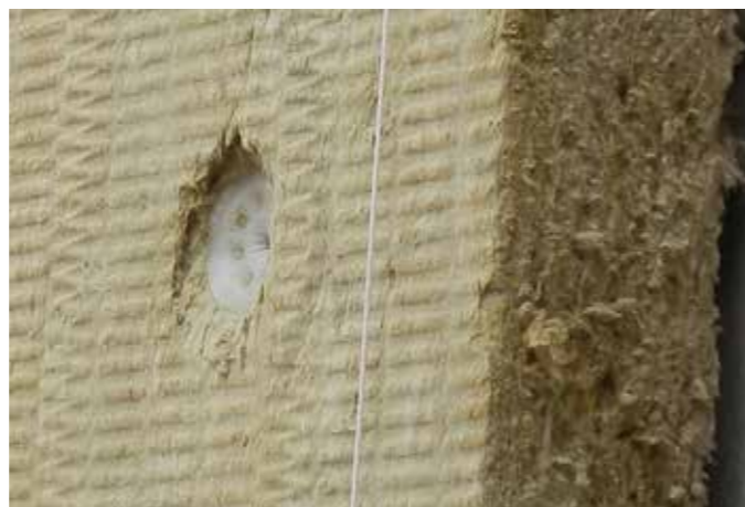
Primjer nepravilno postavljenije pričvrsnice
