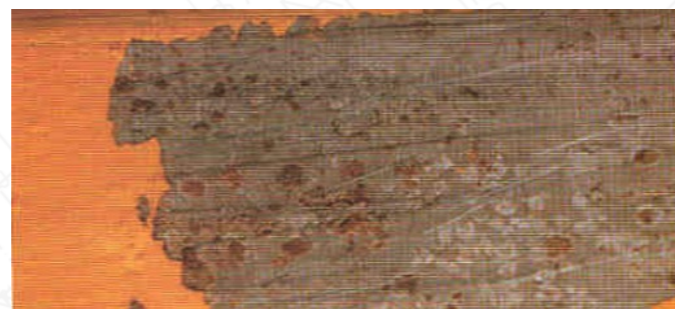
Slika 3: Točkasto prohrđavanje radi ne odstranjene okujine
